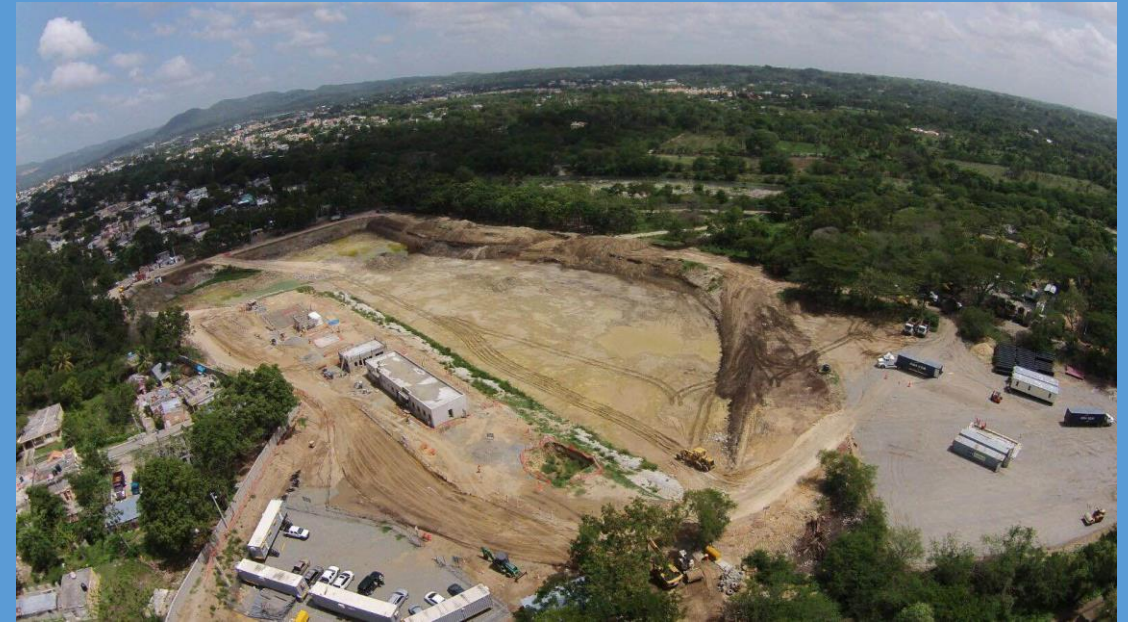
PTAR-San Cristobal Agosto 2015
