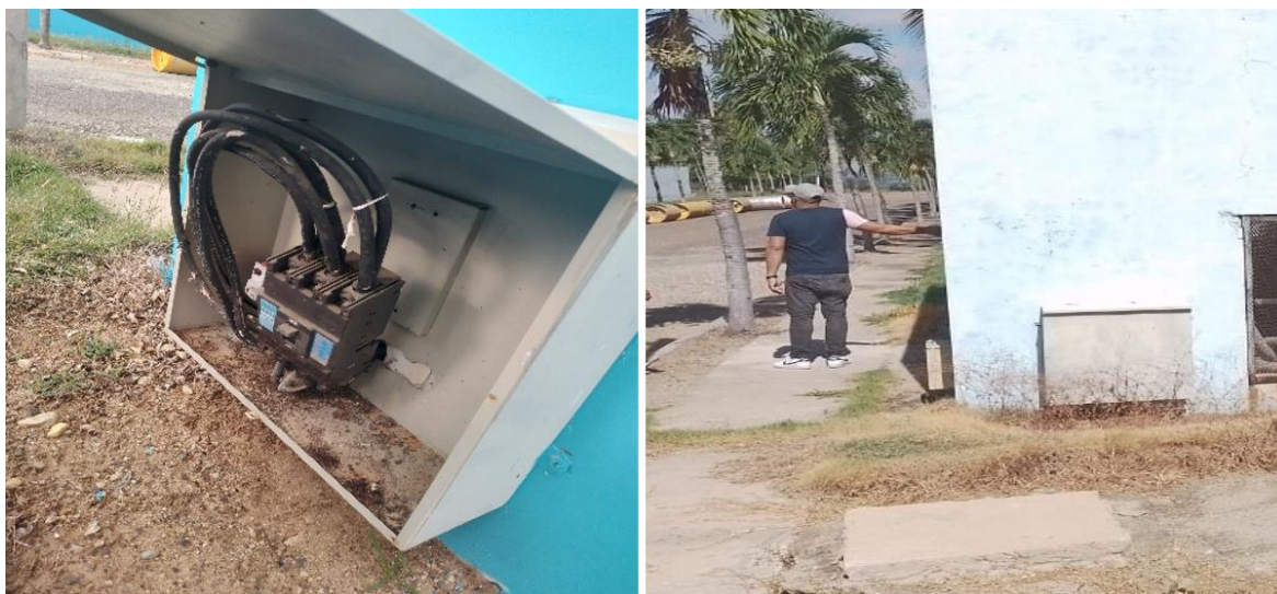
Fotos: Levantamiento estado paneles eléctricos. Ings. Luis Nivar, Alfredo Pereyra, DPPE- INAPA
