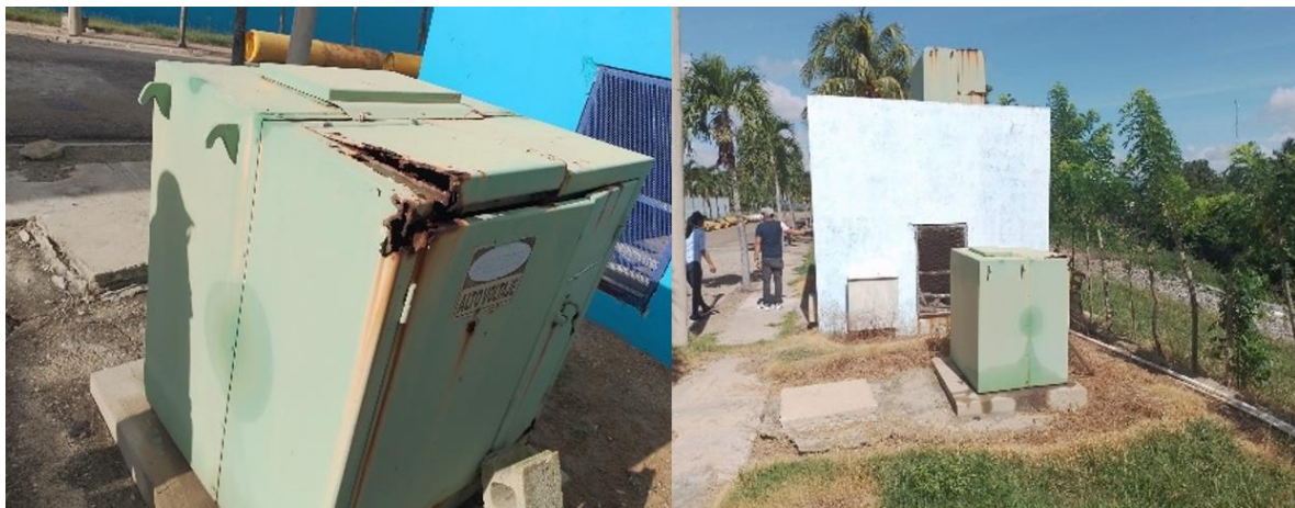
Foto: Levantamiento estado transformadores, Ings. Luis Nivar, Alfredo Pereyra, DPPE-INAPA
