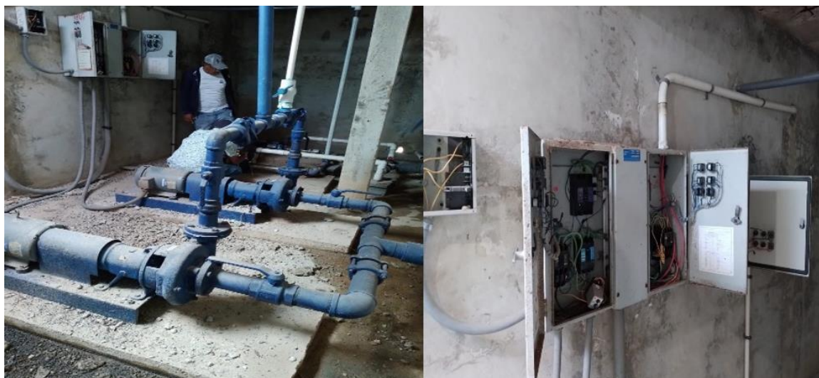
Fotos: Levantamiento estado instalaciones eléctricas. Ings. Luis Nivar, Alfredo Pereyra, DPPE- INAPA
