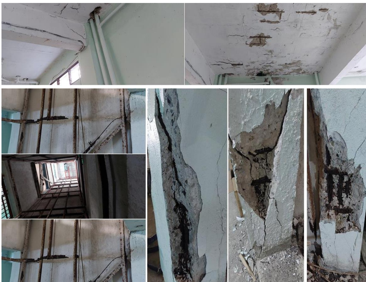
Fotos: Estado actual columnas del elevador, techo y otros elementos. Ing. E. Santana, Documento de Evaluación y propuesta de soluciones PTAP La Dura, 2024.-
