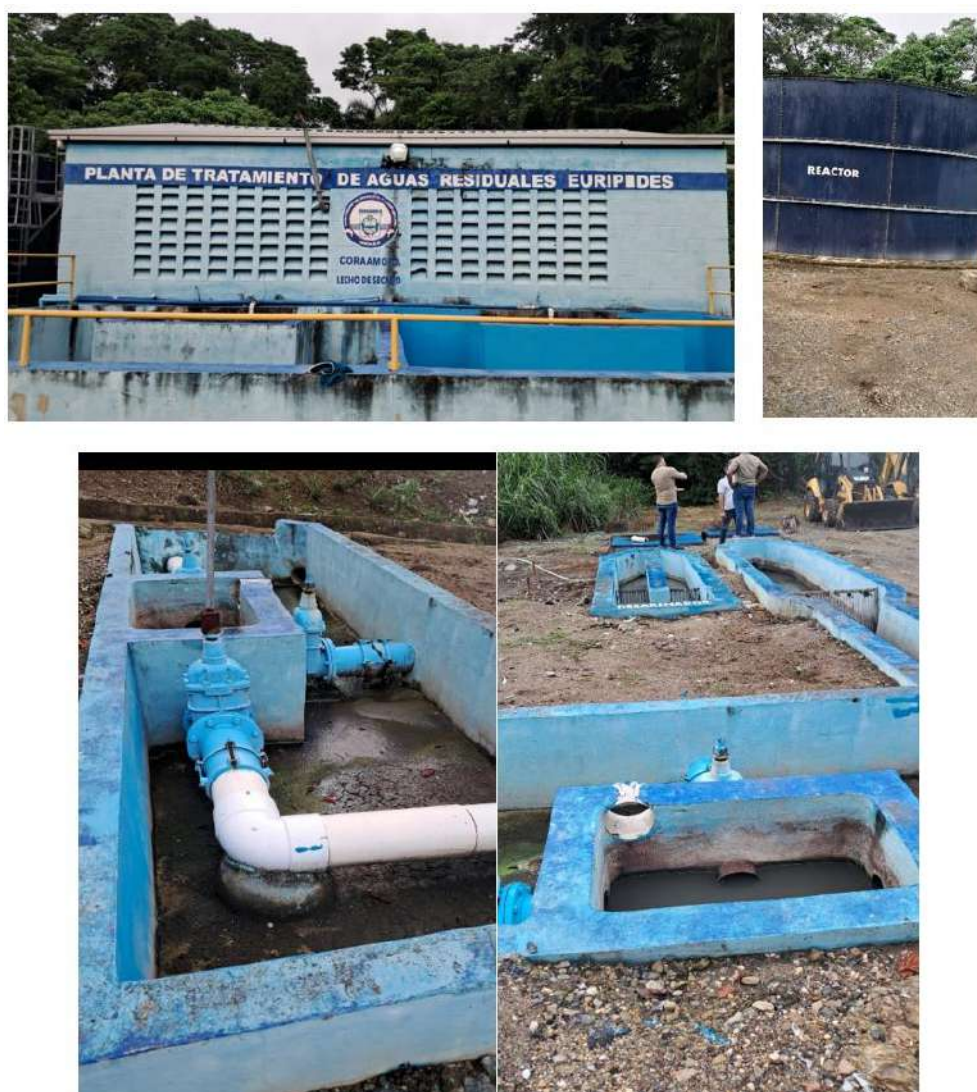
Foto 6.21. Planta de tratamiento de agua residuales bordeada de un denso bosque compuesto por lianas y plantas nativas EBAR 24
