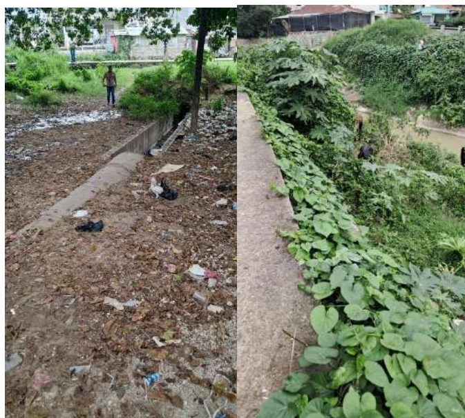
Foto 6.9. Estación de bombeo EBAR 20 (Vegetación de plantas invasoras creciendo en el talud del canal de drenaje)
