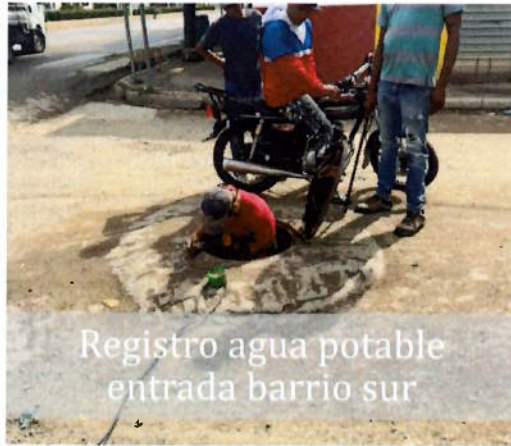
Macro medidor de caudal
